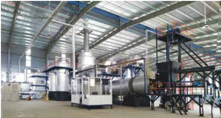
▲ Lò đốt là trái tim của Nhà máy với công suất đốt của 2 lò khoảng 48 tấn/ngày
