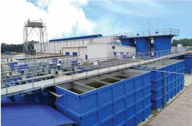
▲ Hệ thống xử lý nước thải với công suất 203 m³/ngày
