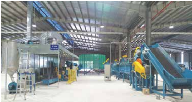
▲ Hệ thống tái chế nhựa cũng là 1 trong những hệ thống nổi bật của Nhà máy
